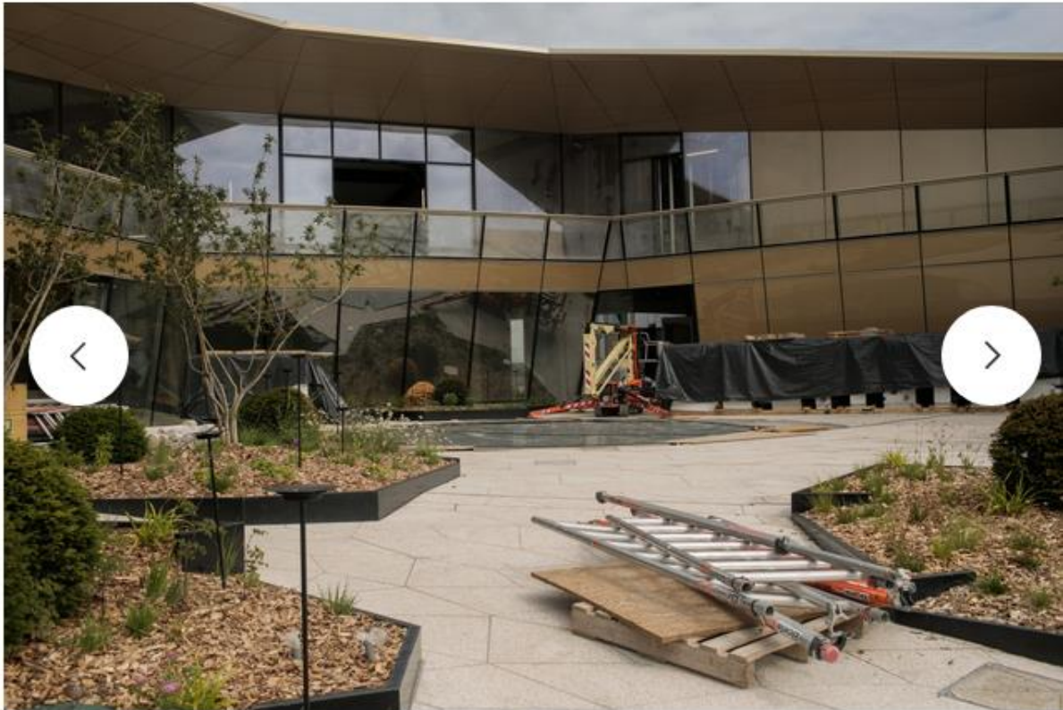
Le restaurant Manko devrait ouvrir sur 700m 2 à la fin de cette année, avec six mois de retard sur l'agenda. (Photo: Matic Zorman / Maison Moderne)
